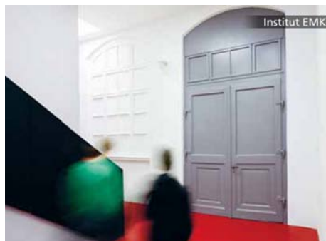
Abbildung 10.9: Spuren der Sanierung: Die ehemalige Hauptwand dient heute als Trennwand zu den Versuchsräumen. Das alte Außenfenster und die ehemalige Außentür wurden markant hervorgehoben.
