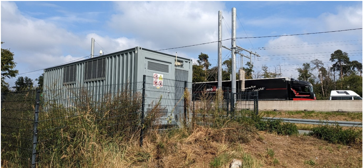
Abbildung 11: Unterwerk an der Bundesautobahn A5 am Parkplatz Bornbruch (eigene Aufnahme, 2024).
