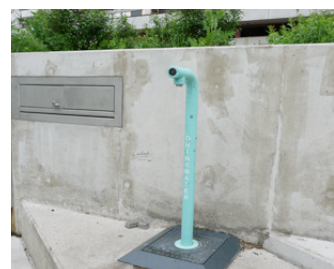
Trinkbrunnen in Becken 1
