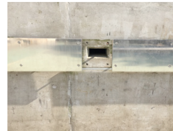
„Waterfall“, fehlende Abdeckung
