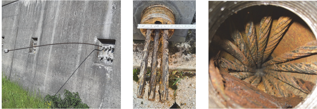
Bild 3 Schäden an Zugelementen, links: Versagte Litze, Mitte: Korrosion am Litzenüberstand, rechts: Korrosion innerhalb des Ankerkopfes
