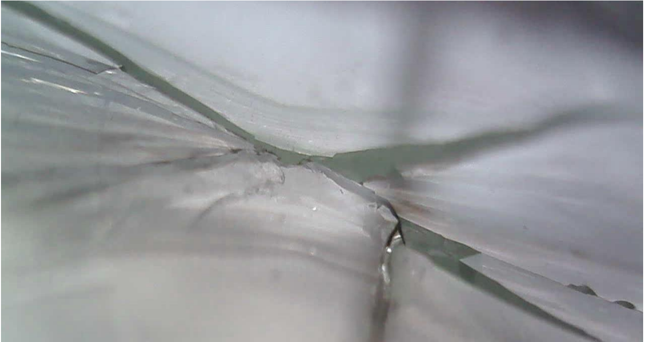
Abbildung 165: Flächenbruch (aus vorheriger Abbildung) in Nahaufnahme, Unterseite mit Bruchursprung
