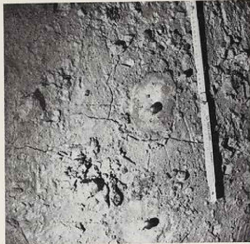
Abb. 9. Zugrisse im Aufbruchbereich, Detail 2.
