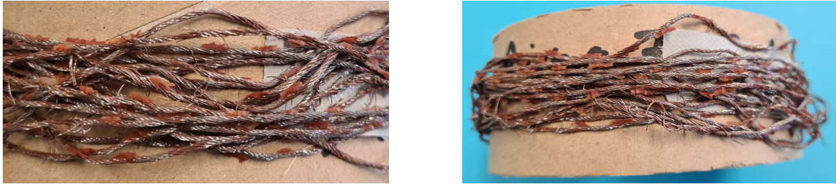
Abbildung 2.4: Freigelegter Zugträger mit gleichmäßig verteilten Drahtbrüchen.
