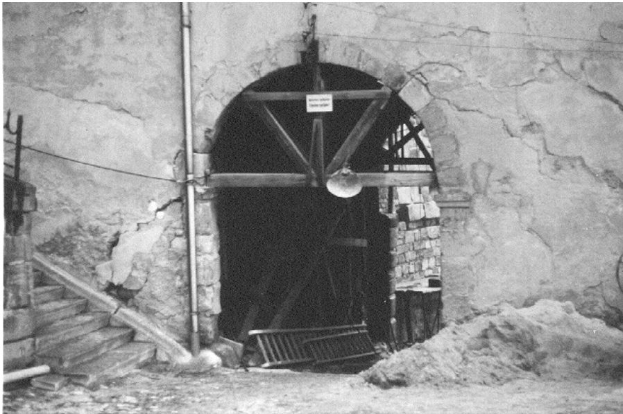
Abb. 3.3: Starke Rißbildung an der "Alten Wache" der Heidecksburg.
