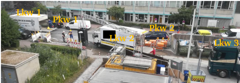
Bild 1: Die Baustellenzufahrt ist durch die gleichzeitige Anlieferung von drei nicht avisierten Transporten überlastet (siehe Lkw 1 bis 3). Die Entladung der Transporte erfolgt teilweise außerhalb des Projekttraums. Es sind Verkehrsbeeinträchtigungen in der Projekttraumumgebung zu konstatieren (siehe Pkw 1 und 2).
