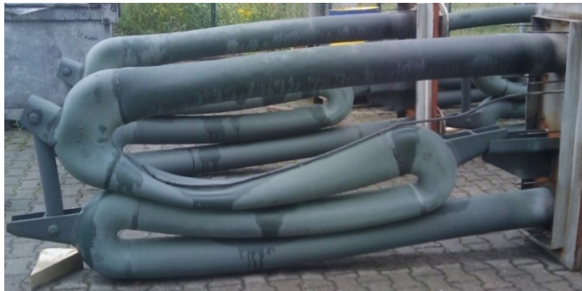
Abbildung 1-1: Strahlheizrohr nach verfrühtem Ausfall durch starke Verformung und Einbüßen der Funktionsfähigkeit [1]
