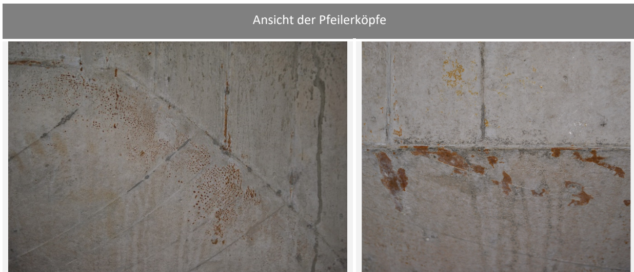
Abbildung 4-44: Braunverfärbungen auf den Sichtbetonflächen der Pfeilerköpfe 345
