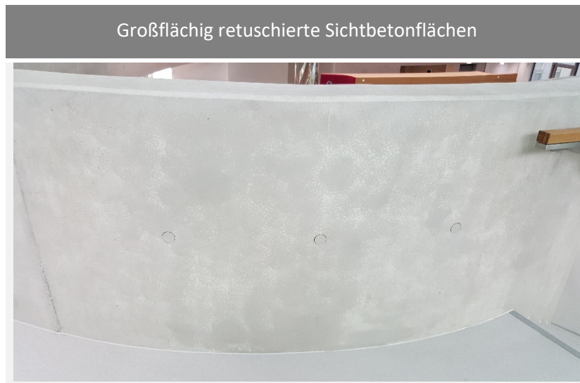
Abbildung 4-66: Großflächig retuschierte Sichtbetonflächen
