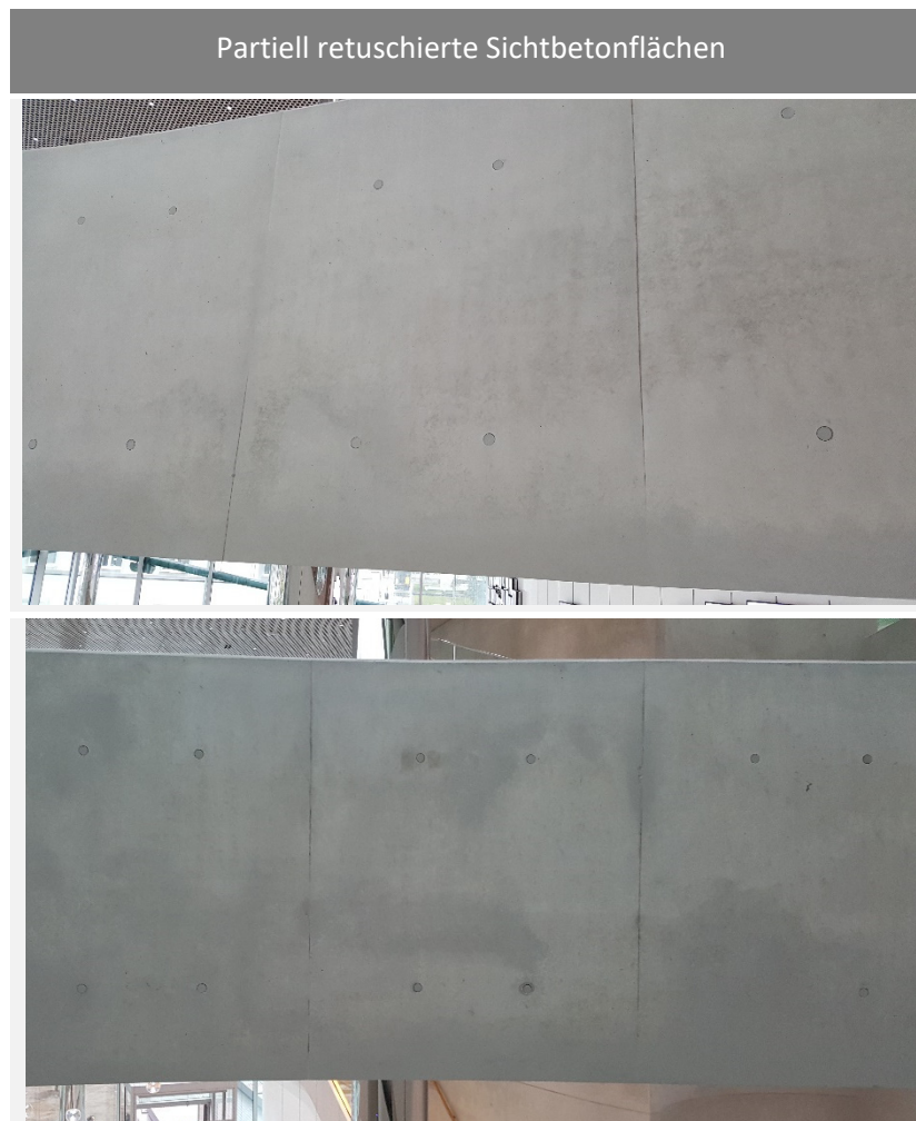
Abbildung 4-65: Partiell retuschierte Sichtbetonflächen
