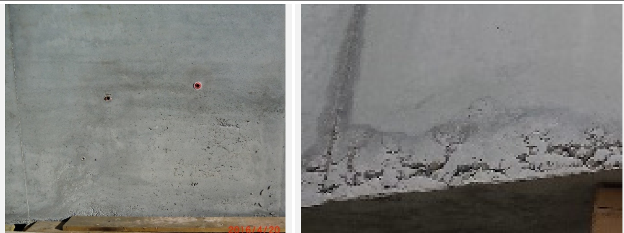
Abbildung 4-64: Sichtbetonflächen bei mangelnder Verdichtung aufgrund zu dichter Bewehrungsführung 407
